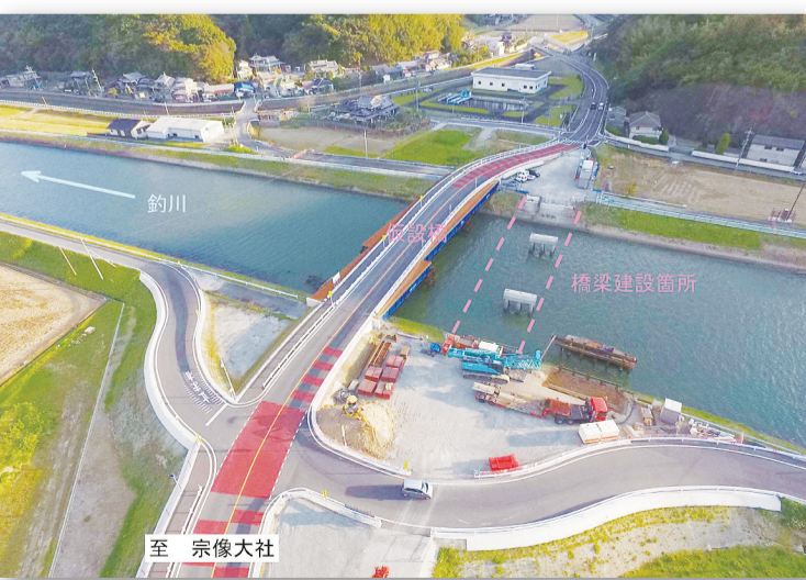
安全と安心のために「川端橋」架替え工事が進行中。宗像大社、鎮国寺が位置する宗像市の歴史文化の中心地。完成後は、同地域のランドマーク的な役割が期待されます。
