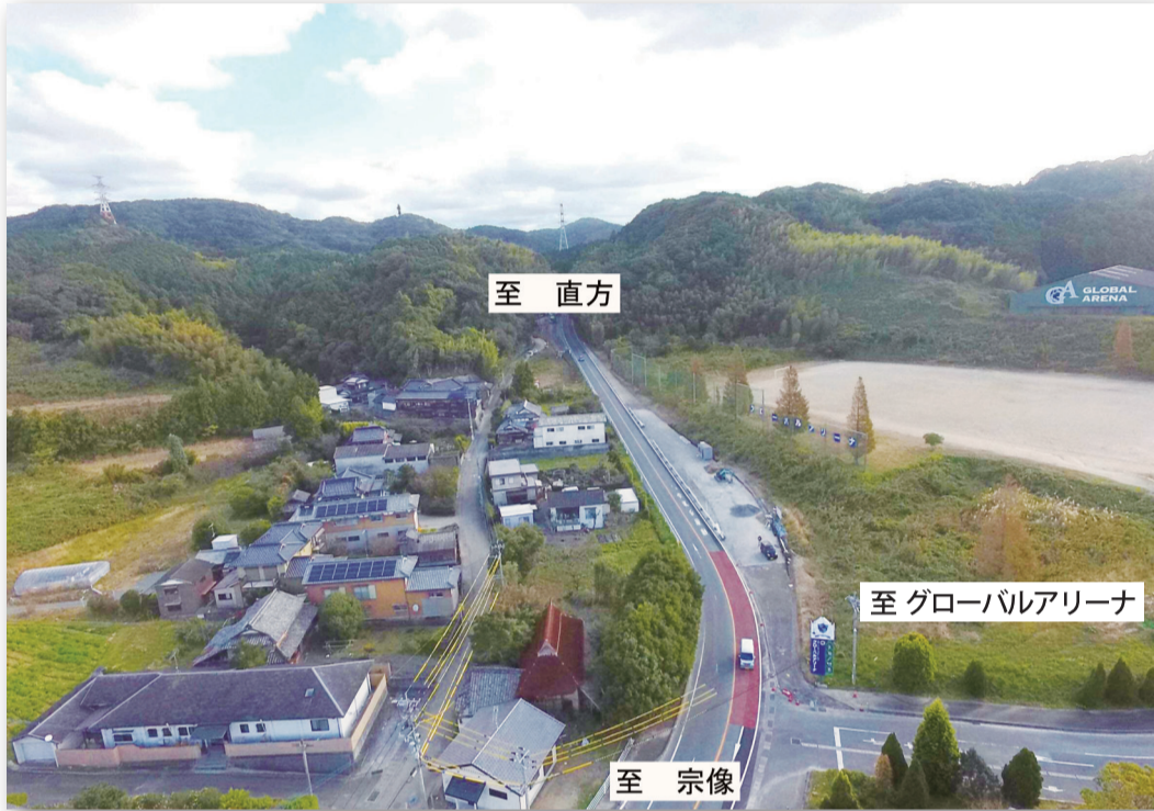
完成が待たれる主要地方道・県道直方宗像線（猿田峠工区）道路改良工事。急カーブの改善、歩道と右折レーンの設置工事。グローバルアリーナ付近の交通の円滑化に向けて着実に工事が進んでいます。
